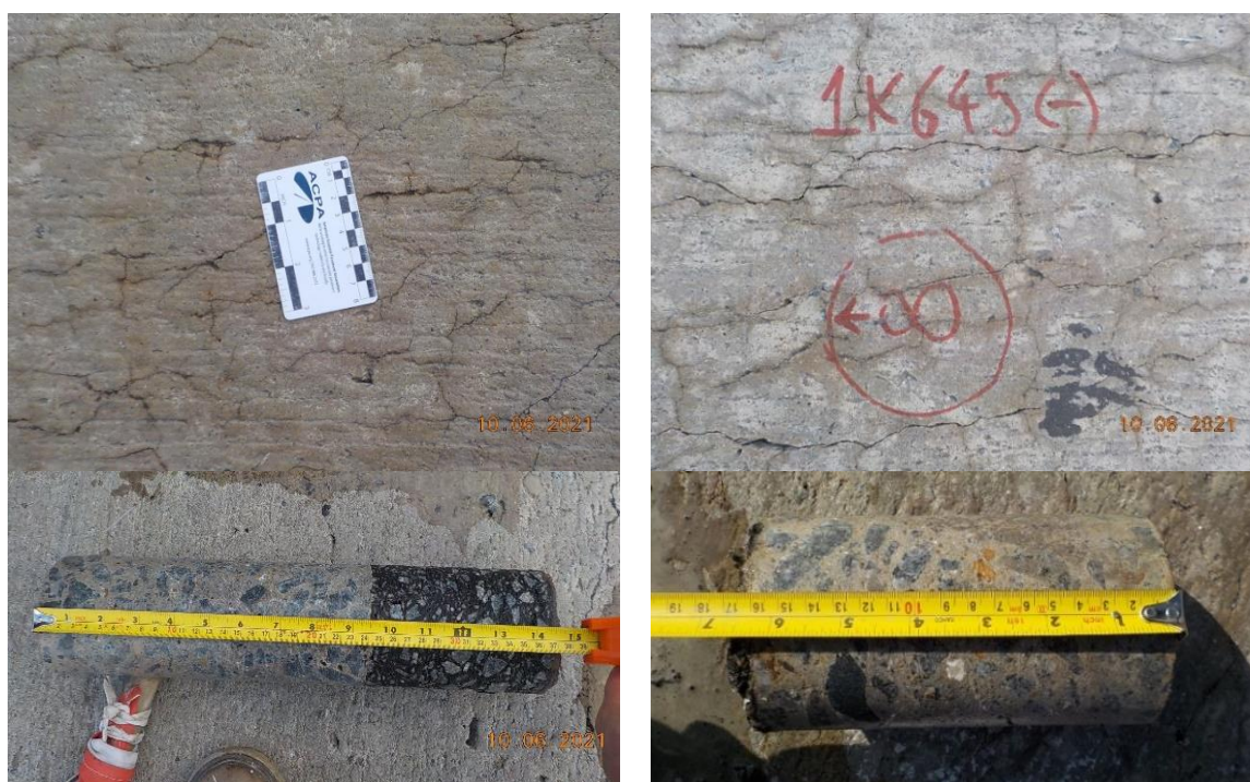
Figura 2. Aspecto de la superficie del pavimento en las zonas A (a) y B (b). Vista de los testigos 1 (c) y 8 (d), de las zonas A y B, respectivamente. Nótese la adherencia entre hormigón y asfalto en el testigo 1 (c) y la ausencia de ésta en el testigo 8 (d).
